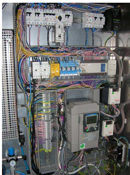
Rys. 2. Widok wnętrza rozdzielnicy wirówki do warzyw.
